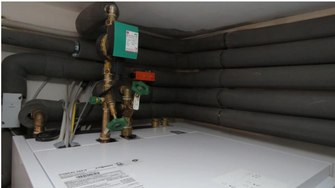
Sie sehen: Verrohrung oberhalb der Anlage
