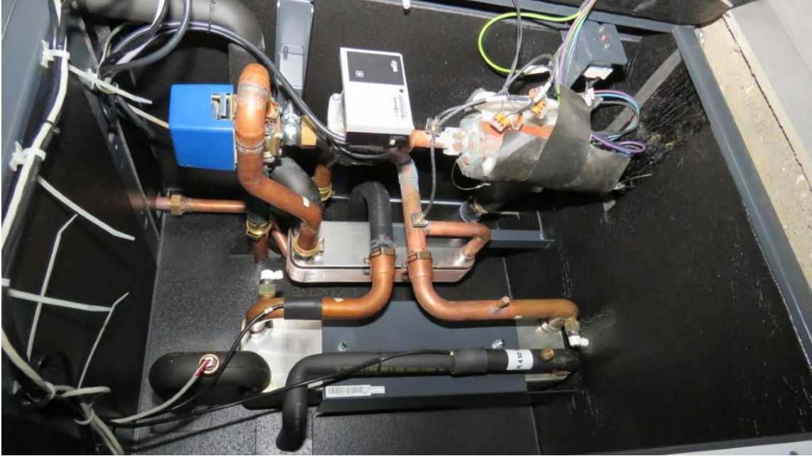
Sie sehen: Wasserrückstände 1
