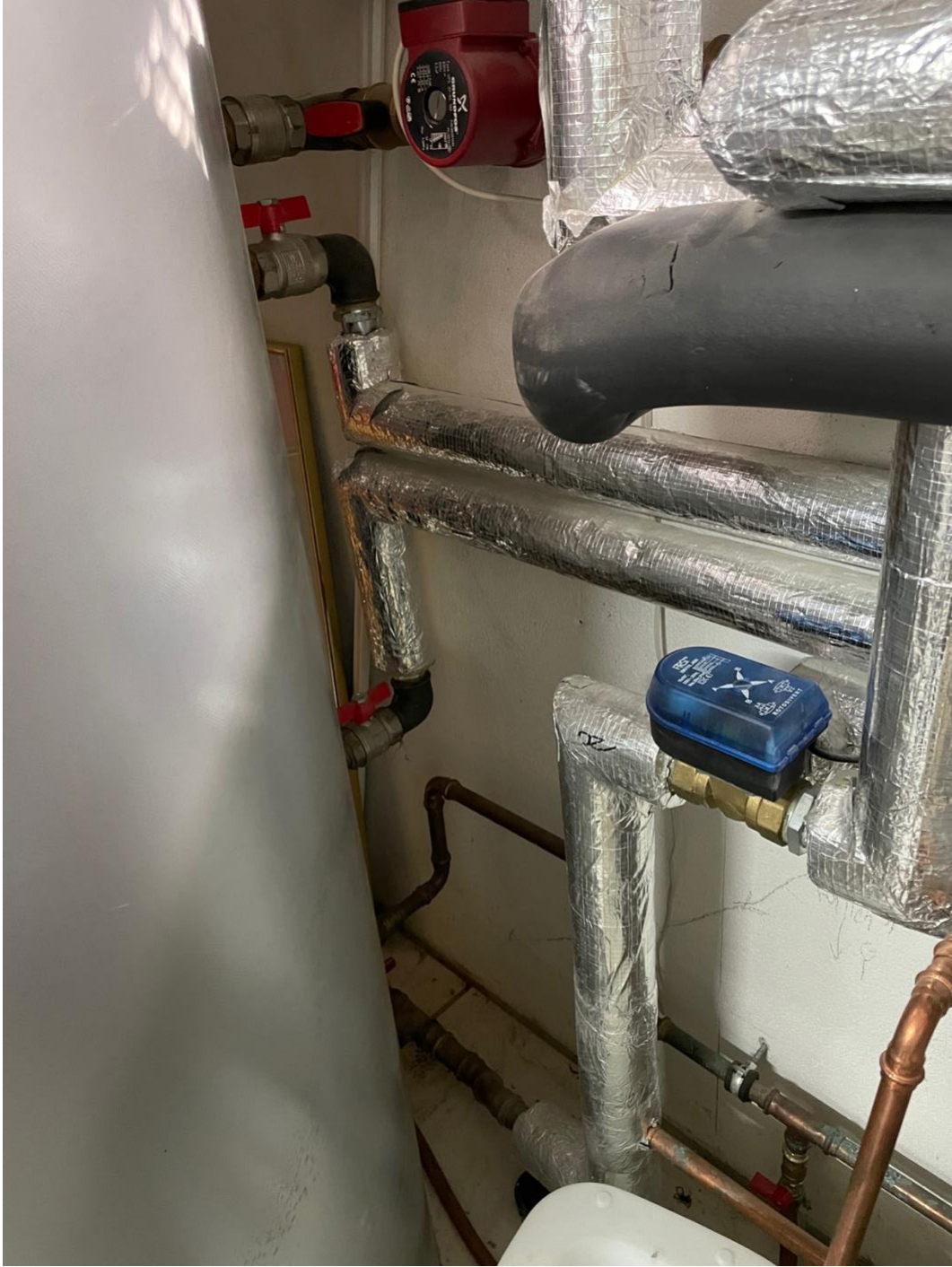
Bild 4 : Zur Info. Speicher und links unten die Befüllung für Heizkreislauf
