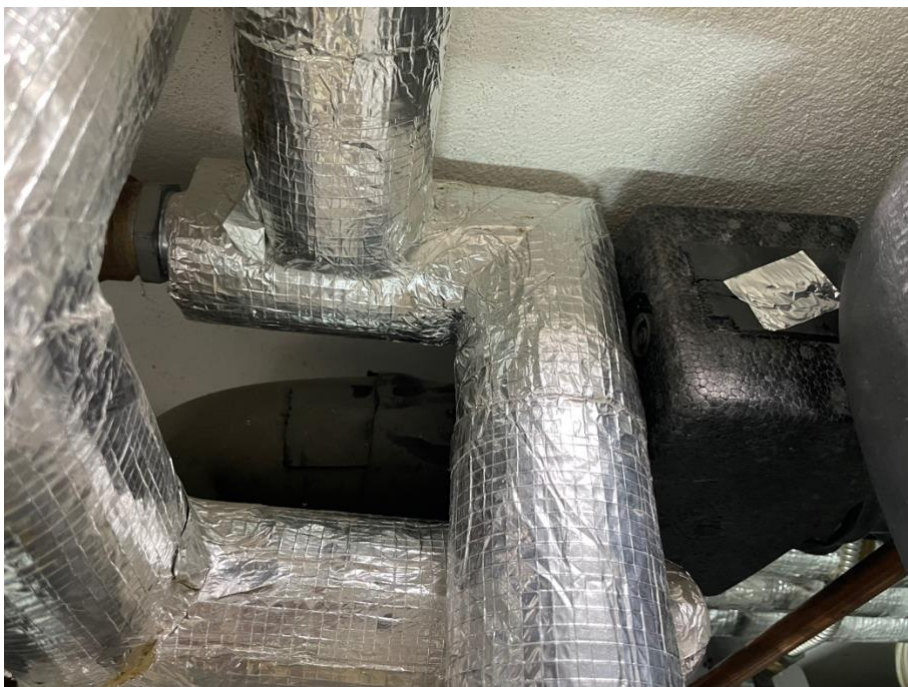
Links neben oberer Baugruppe ist ein Schaum-geschütztes Ventil . Ich habe die Dämmung entfernt . Da ist eine Beschriftung „Flamcovent..“ Es gibt auch einen Stutzen nach links, der
