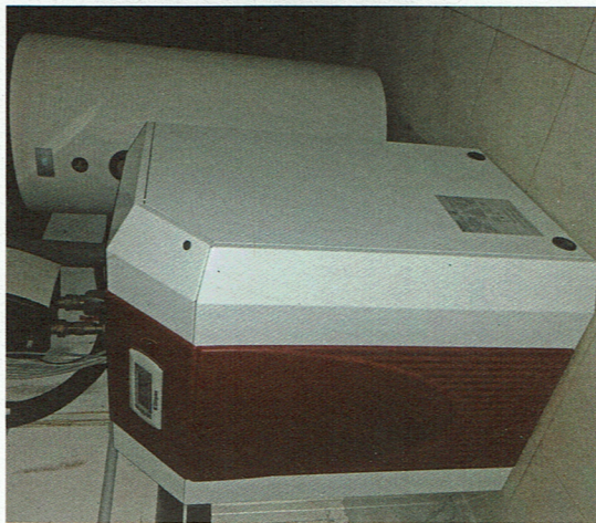
Abb. 5: Wärmepumpe und Pufferspeicher der Familie N.
